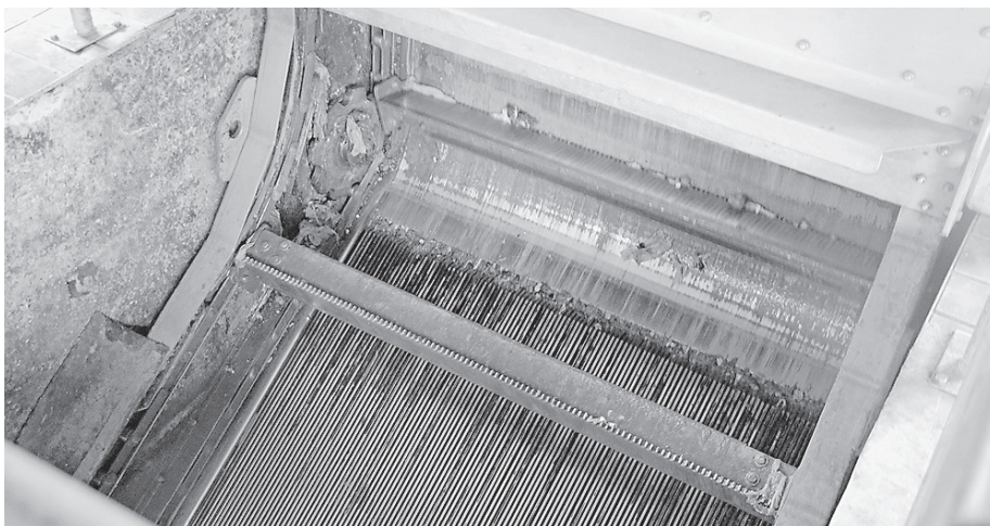
Im Umlaufrechen werden größere Teile aus dem Abwasser gefiltert.
