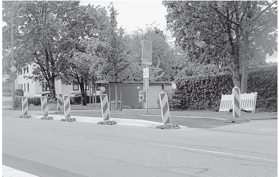
Die Bushaltestelle am Pamiersring wurde bereits zu einem barrierefreien Buskap umgebaut. Foto: Stadtverwaltung
